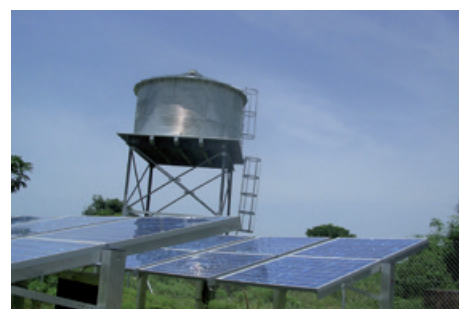
Alimentation d'une pompe pour puiser l'eau
