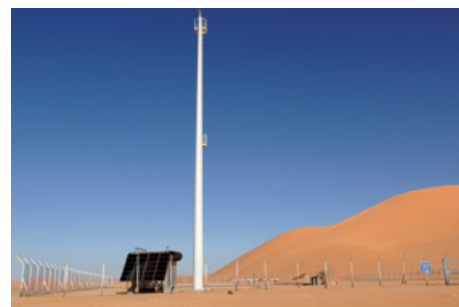
Antenne de transmission d'information
